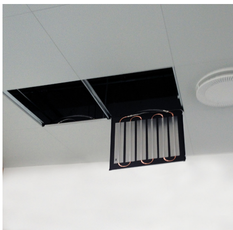
Køle-/varmeslangerne ligger skjult under loftet i sektioner, og kassetterne kan flyttes til andre steder i rummet, hvis der er behov for det.
